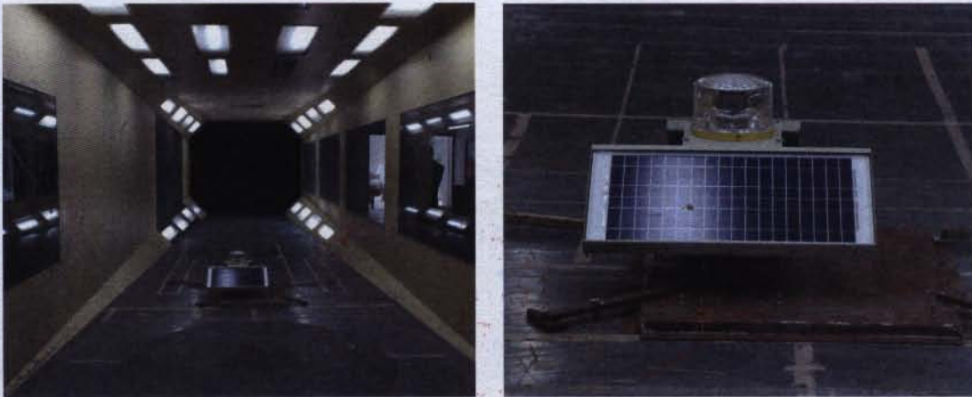
图 1 安装在 TJ-2 风洞底板上的 LT505 中光强太阳能航空障碍灯
